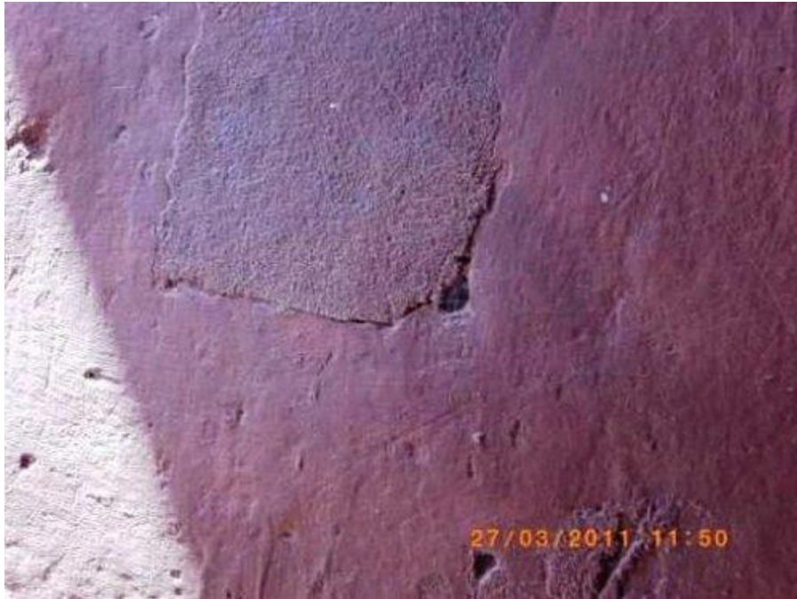
Impact d'un tir à l'arme lourde récemment colmaté
